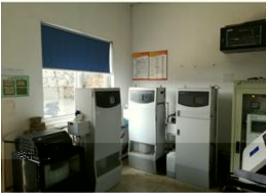
废水处理站南区废水在线监控设施
