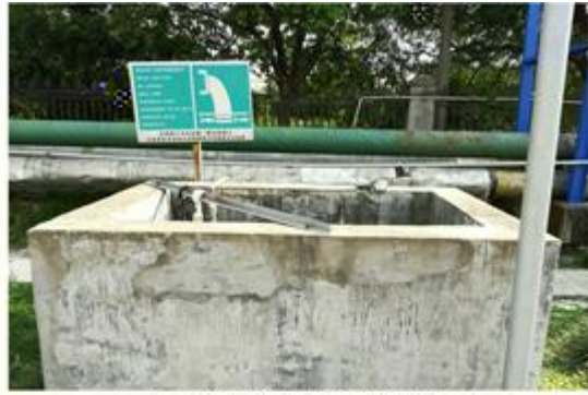
废水处理站北区标准化排放口
