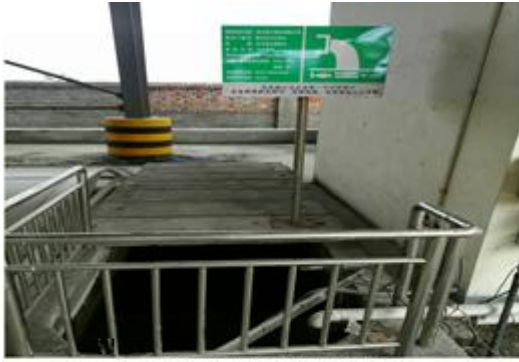
废水处理站南区标准化排放口
