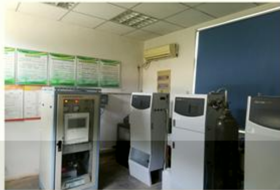
废水处理站北区废水在线监控设施
